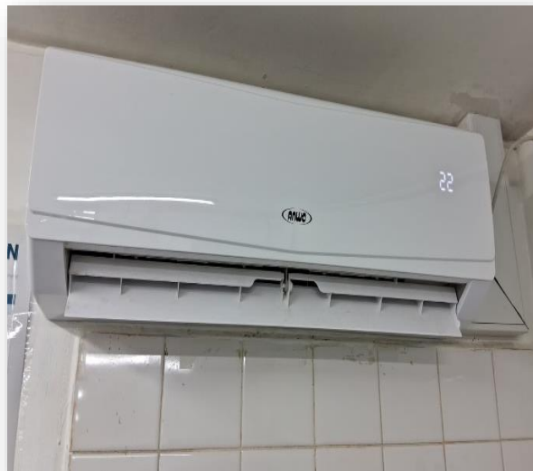
Aire acondicionado inverter 12.000BTU"
